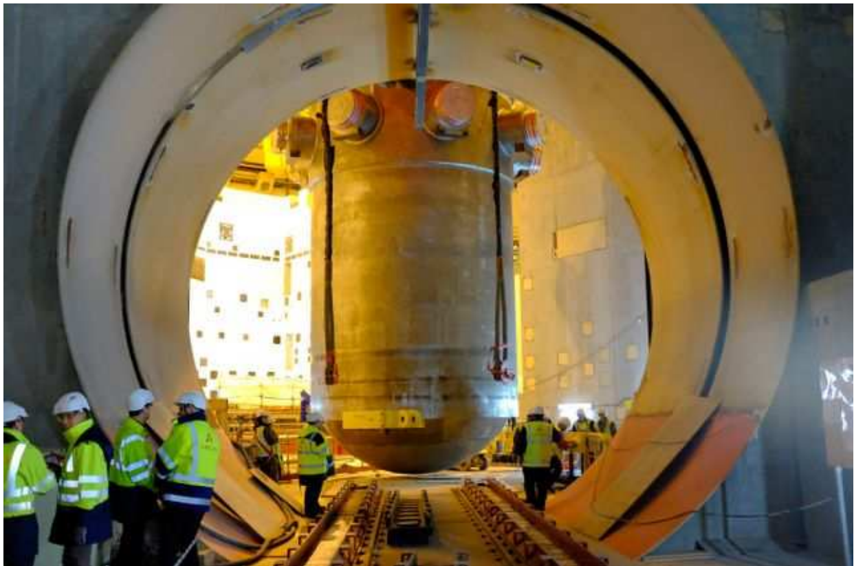
Druckbehälter des EPR des KKW Flamanville
